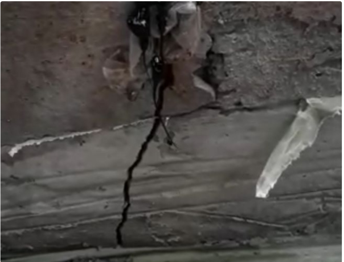
Proyek Jalan Putat Nutug-Babakan yang baru rampung terlihat sudah patah
